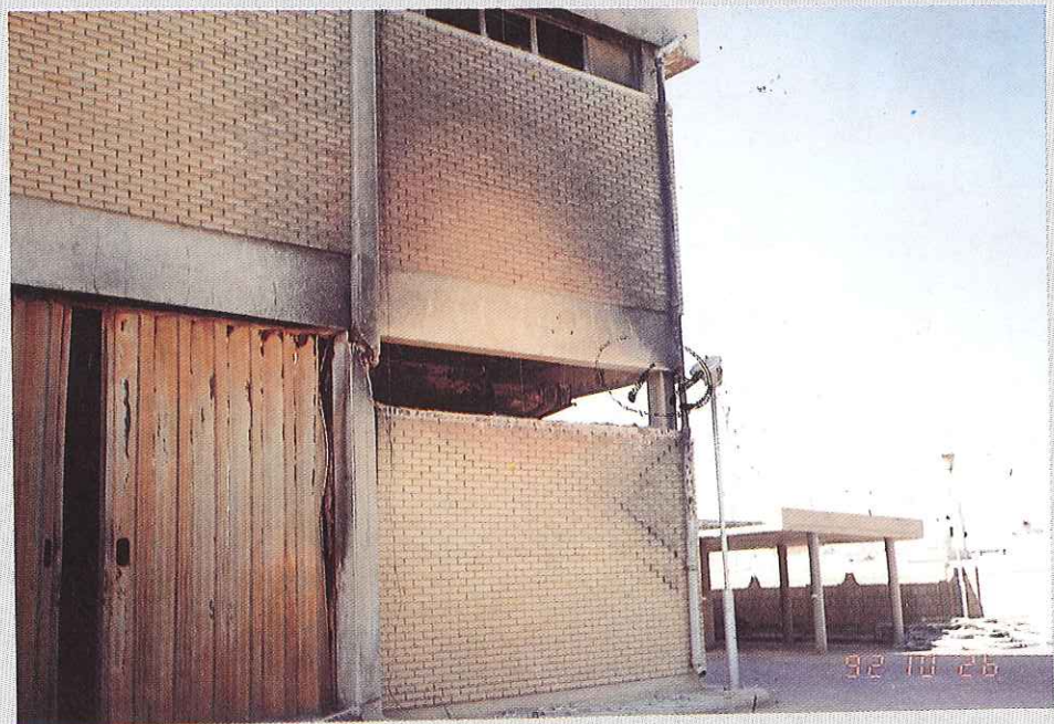
(2) الضرر الأكبر في الواجهة الشرقية
