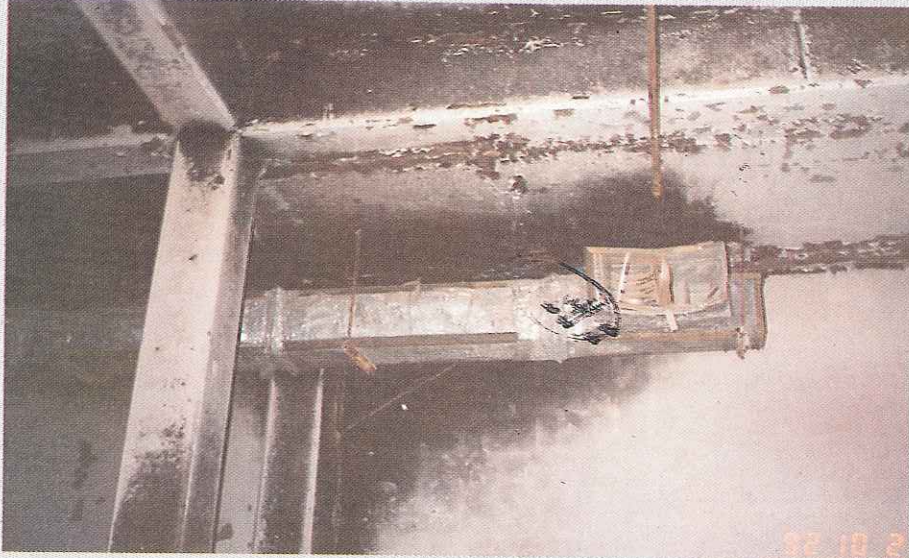
(3) آثار الحريق داخل المبنى
