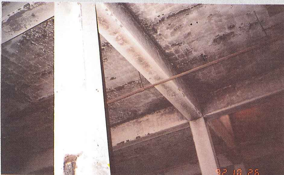
(1) الضرر أقل داخل المبنى
