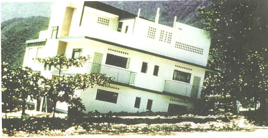
■ زلزال فنزويلا 29 يوليو 1967، الصورة تظهر انهيار التربة تحت المنزل والتي تسببت في الهبوط الشديد في أحد جوانب المنزل
