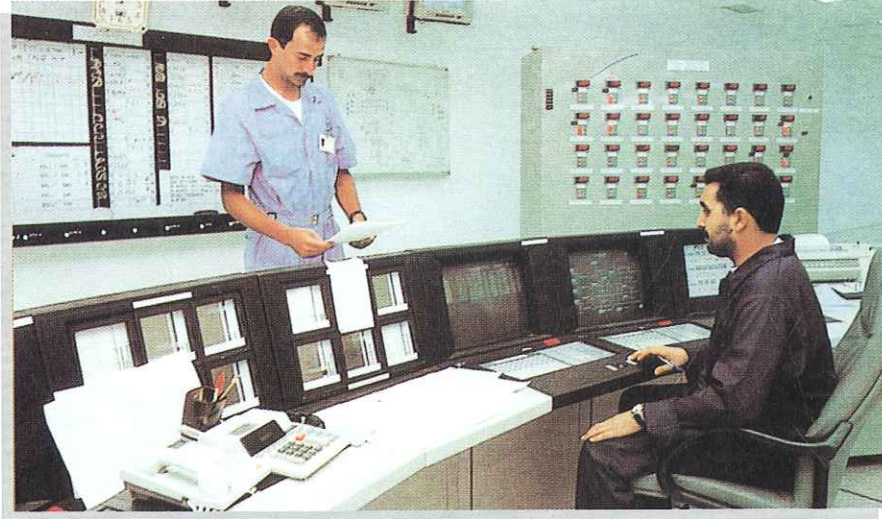
■ (الشكل - 3) غرفة التحكم داخل مركز التجميع ■
