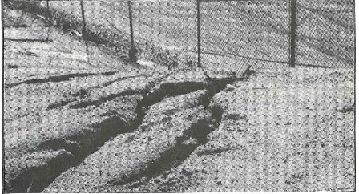
الشقوق بفعل المياه القادمة من خارج حرم الطريق
