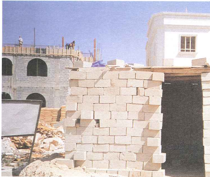
غرفة حراسة من الطابوق ويلاحظ عدم متانتها ومطابقتها لشروط السلامة.
