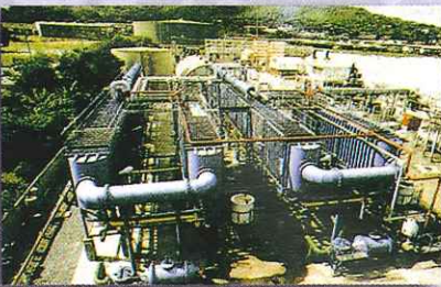
محطة لتحلية المياه
