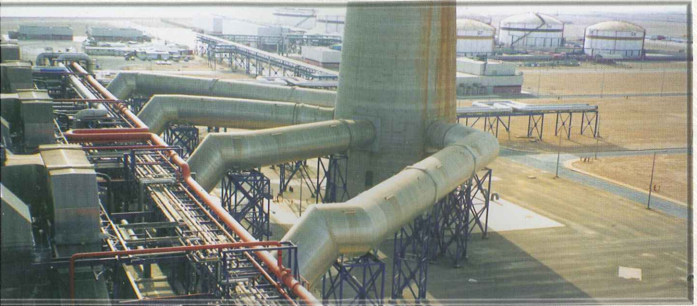
إحدى مدخنتي المحطة وخطوط خروج الغازات الناتجة عن إحتراق الوقود داخل الغلايات وتبدو أيضاً خزانات الوقود السائل
