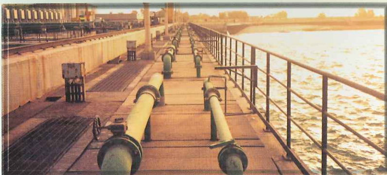
جانب من مأخذ مياه البحر في محطة الواحة الغربية.
