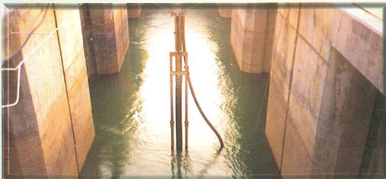
إحدى شبكات الترسيب الأربعة الموجودة ضمن مآخذ مياه البحر لمحطة الدوحة الغربية
