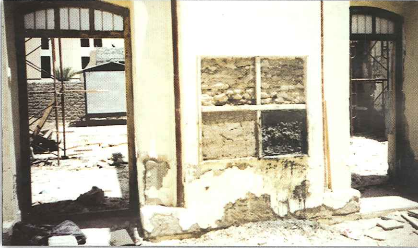
صورة توضح مراحل الترميم في حائط مسجد الخليفة وهي أربعة أ- الكشف على الطابوق. ب- حقن الطابوق الطيني. ج- الطرطشة وإضافة المواد المعدنية والمساح.
