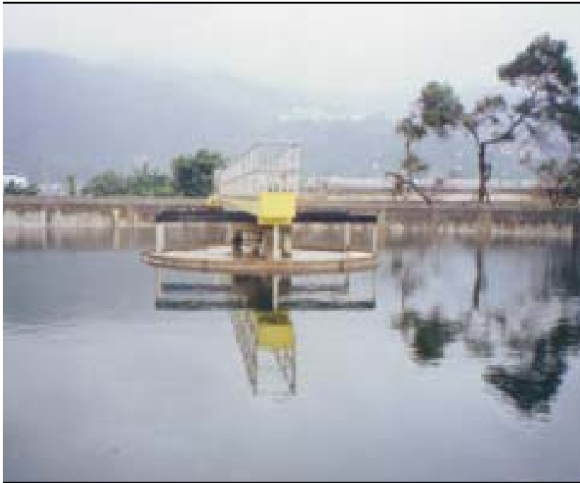
أحواض الترسيب في محطات معالجة مياه الصرف الصحي
