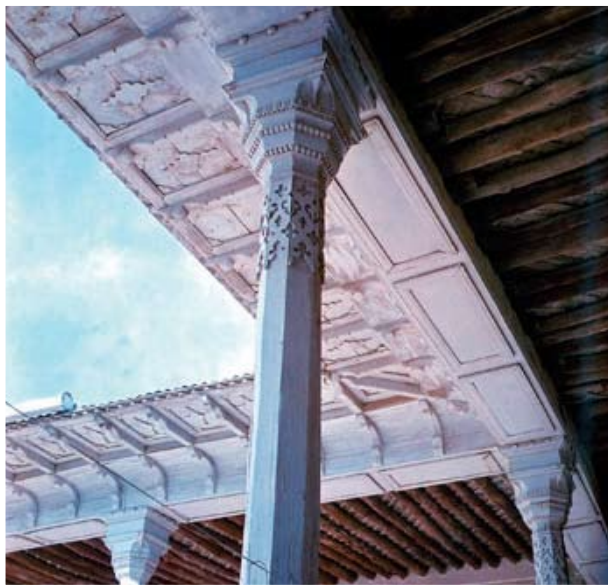
شكل (4) صورة واجهة داخلية لأسقف الليوان وتبين الإهتمام بتفاصيل تصميم الأعمدة وتيجانها بالإضافة إلى الدنشل المستخدم لتغطية السقف.
